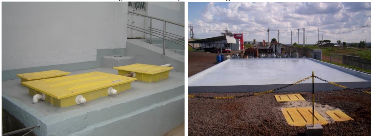
Figura 2 – caixas separadoras de água e óleo
