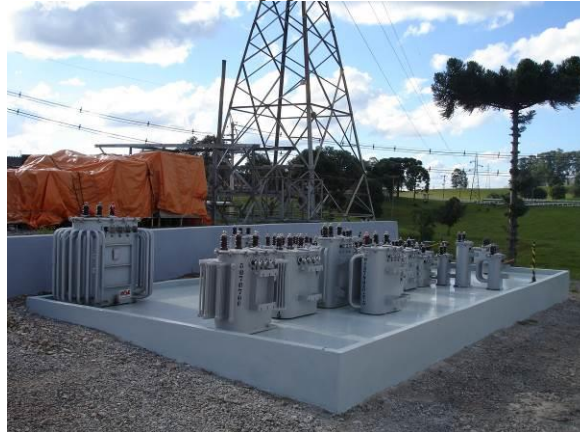
Figura 1 – Pisos impermeáveis para armazenamento de equipamentos
